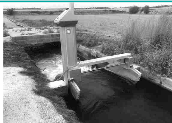
▲ Sistema de control automàtic de canals i reg per superfície.
