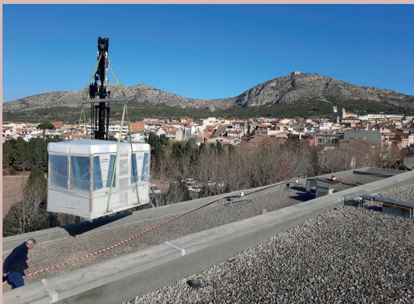
Treballs d'instal·lació dels nous aparells climàtics a la coberta de l'Espai Ter.
