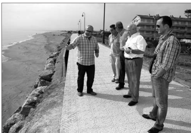
L'alcalde mostrant a tècnics de Costes els desperfectes.
