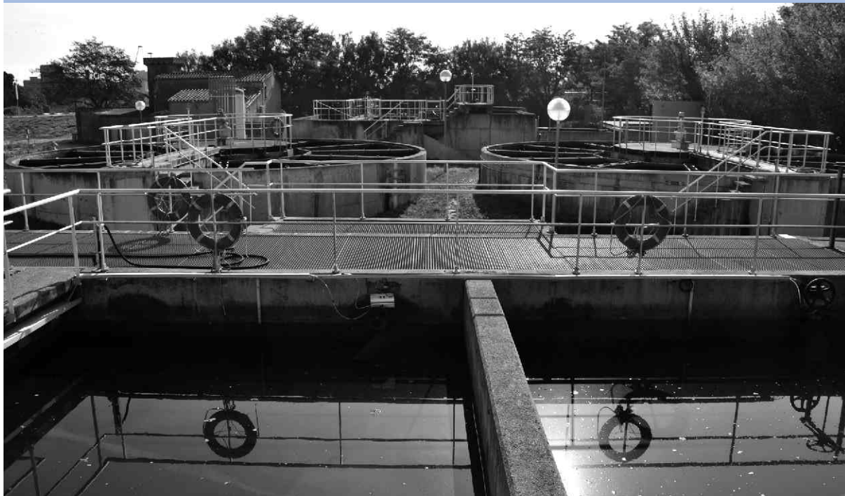
▼ Basses de decantació i filtració d'aigua, a la planta potabilitzadora. Foto: Puri Abarca
