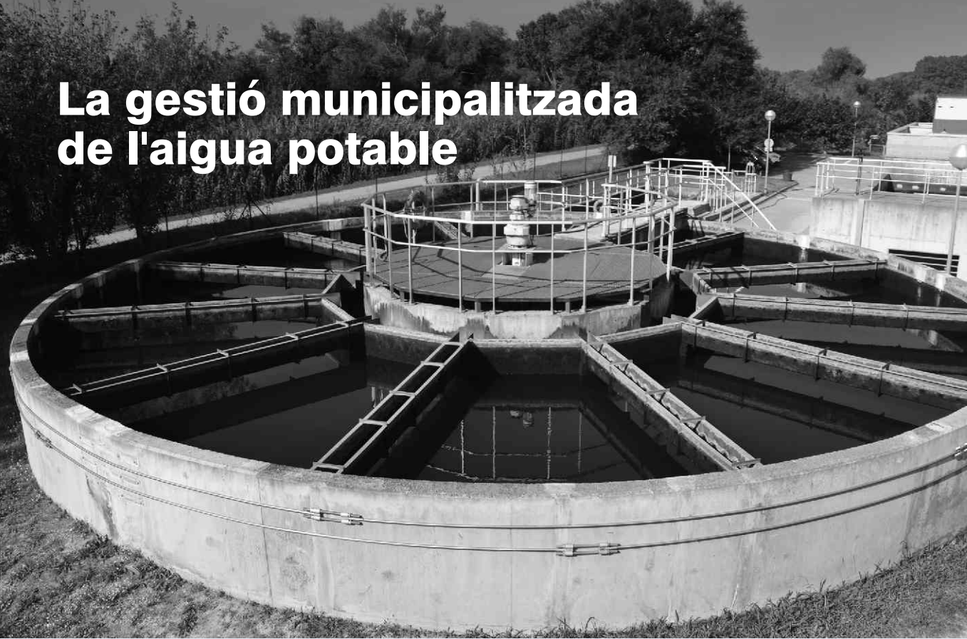
▲ Una de les instal·lacions de decantació d'aigua de la planta potabilitzadora, l'ETAR. Foto: Purí Abarca
